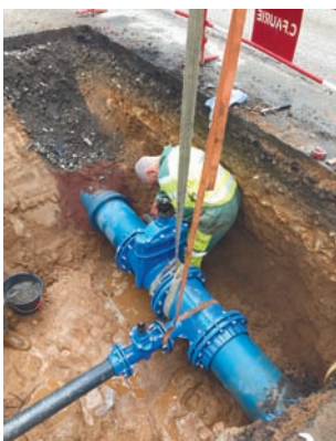
Vanne d'eau potable DN300
