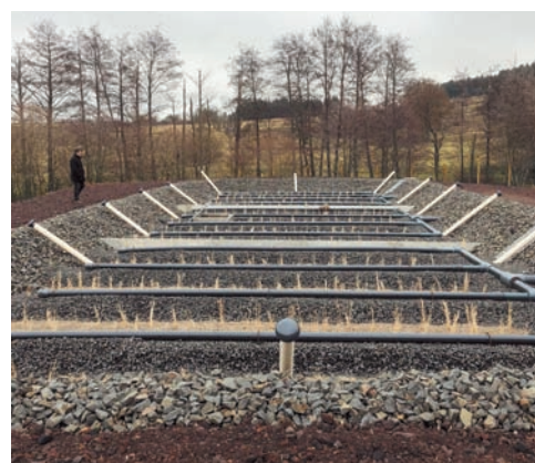
Station d'épuration par filtre planté de roseaux
