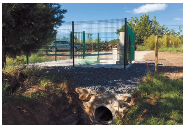
Poste de relevage des eaux usées
