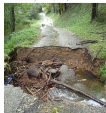
Vue du pont de Saint-Prix à Saint-Agrève emporté par les eaux.
